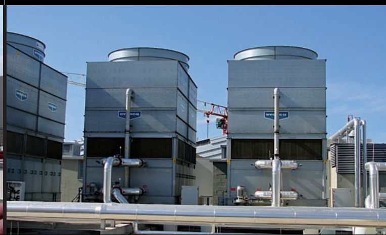
LA CENTRALE FRIGORIFERA. Il sistema prevede dodici condensatori evaporativi collegati all'anello d'acqua.
