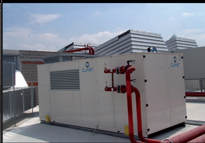
LA CLIMATIZZAZIONE. L'impianto di climatizzazione utilizza pompe di calore ad anello d'acqua e unità roof top.
