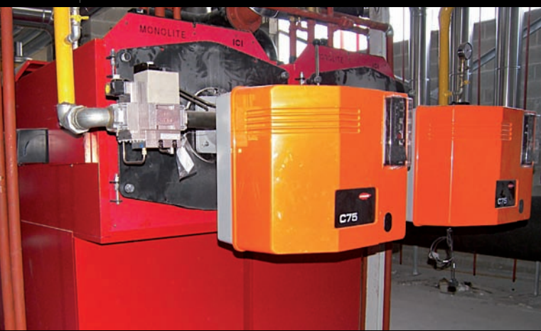
IL RISCALDAMENTO. La centrale termica si compone di cinque caldaie a condensazione da 1,3 MW di potenza cadauna.
