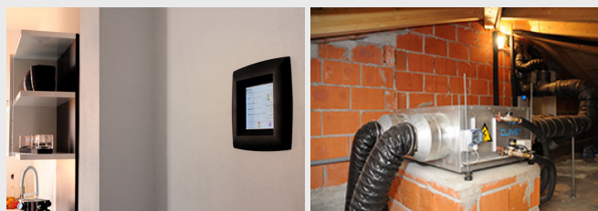
Casa Privata - ELFOControl nella zona soggiorno/cucina ed ELFOFresh in vano di servizio
