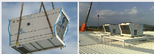
Cémoi Cantalou ... Posizionamento delle unità di climatizzazione sulla copertura
